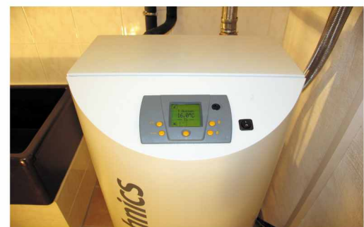
Auch in beengten Raumverhältnissen lassen sich Wärmepumpen optimal installieren. (Quelle: SunTechnics GmbH, Hamburg)
