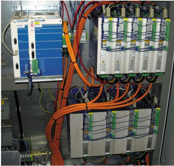
Einblick in den Schaltschrank für die Steuerungs- und Antriebstechnik der 'twinlas'. Zu sehen sind der Hochfrequenzumrichter ACO5000 (links) und die digitalen Servoverstärker SERVOSTAR 600 (rechts). (Quelle: give4pr, Essen)
