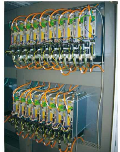
Die digitalen Servoverstärker Kollmorgen S700 steuern im Schaltschrank der Firma Koch Pac-Systeme bis zu 50 Servo-Achsen an. (Quelle: give4pr, Essen)
